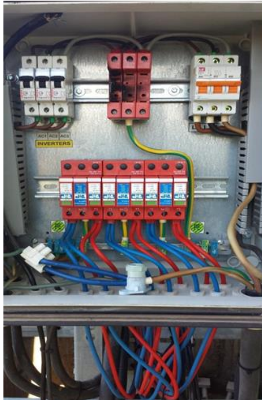
Abbildung 10 – Überprüfung des Erdungssystems im Schaltkasten
