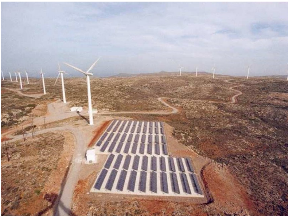
Figura 1 - instalación de escala PV situado en tierras yermas de muy bajo valor.
