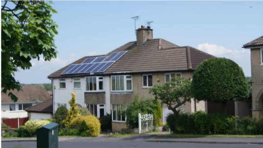
Figure 2 : panneaux PV sur le toit d'une maison en Grande-Bretagne
