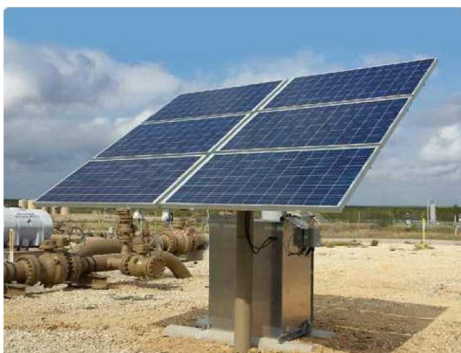
Figure 18 : protection cathodique utilisant des panneaux PV.
