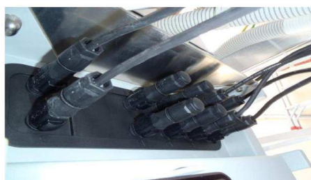
Figure 7 - Contrôle de toutes les connexions
