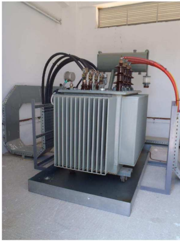
Figure 11 - Transformateur Moyenne tension
