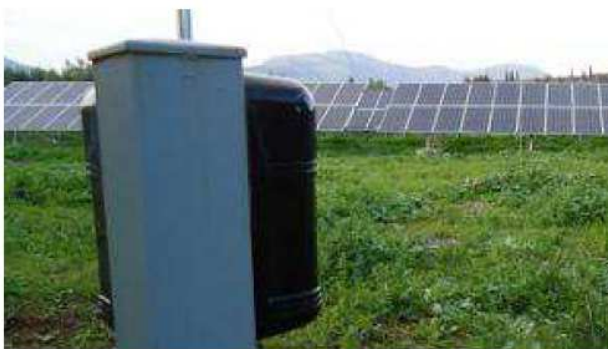
Figure 13 : capteur d'alarme de sécurité
