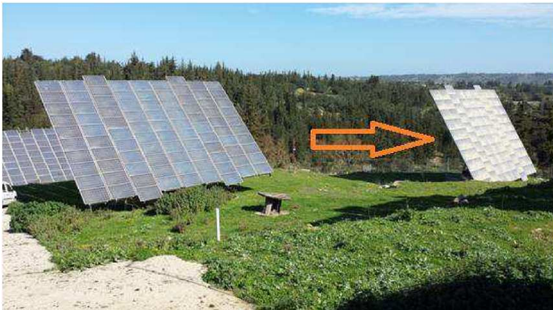
Figure 4 - Panneau visiblement encrassé
