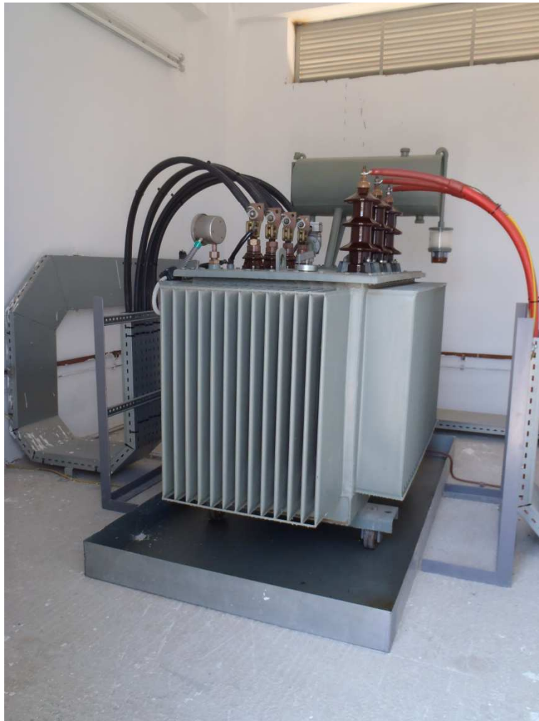
Εικόνα: Μετασχηματιστής μέσης τάσης
